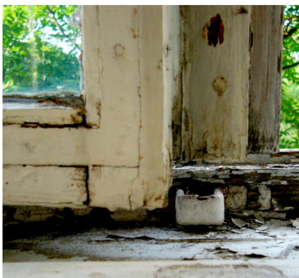
Es lohnt sich: ob verrottet oder zugig, Architekt Paal saniert alte Holzfenster nachhaltig und preiswert.
