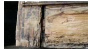
Foto 1: Die Zapfen der Eckverbindungen sind im Sockelbereich bereits stark durch Holzfäulnis beschädigt.
