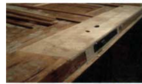
Foto 4: Ein stark beschädigter Schlosskasten lässt sich auch mit Holzpassstücken reparieren.
